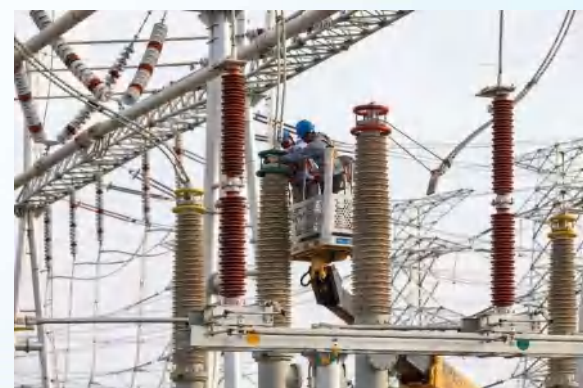
6月12日,濮阳市电力建设重点工程——500千伏新濮输变电工程全面启动。它的建成投运,使濮阳电网的供电能力提高一倍以上,对我市经济发展起到了巨大的促进作用。
