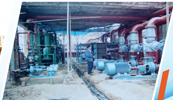
濮阳市第一供热站开始集中供暖。
