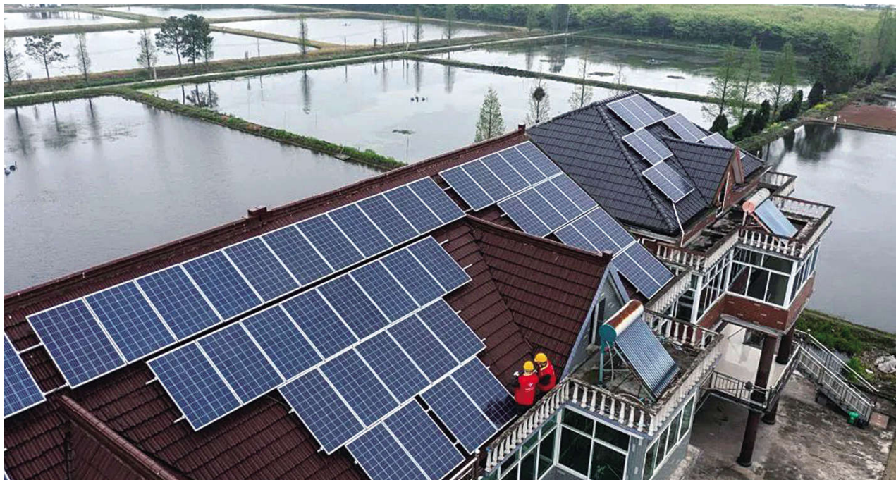
在浙江省湖州市德清县乾元镇齐星村，工作人员为当地村民的太阳能屋顶光伏电站巡检。
